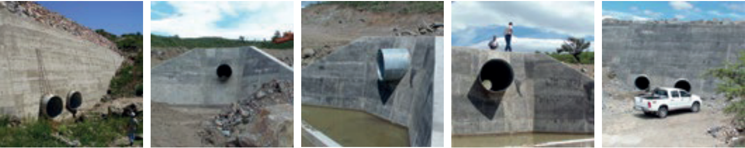
Túneles TV 152 Minera Michilla
